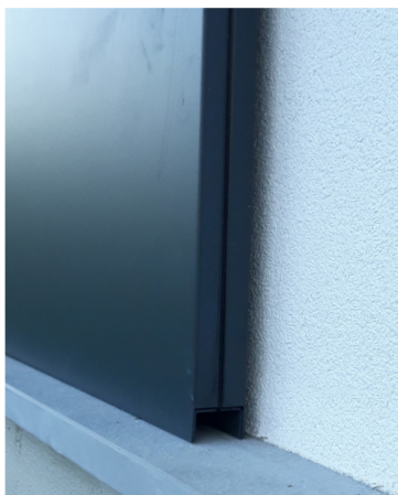
Particolare parte inferiore anta
